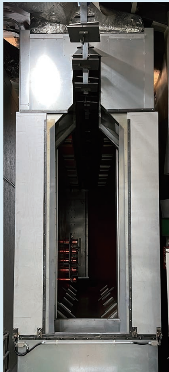
▲ハイブリッド乾燥炉出口側
