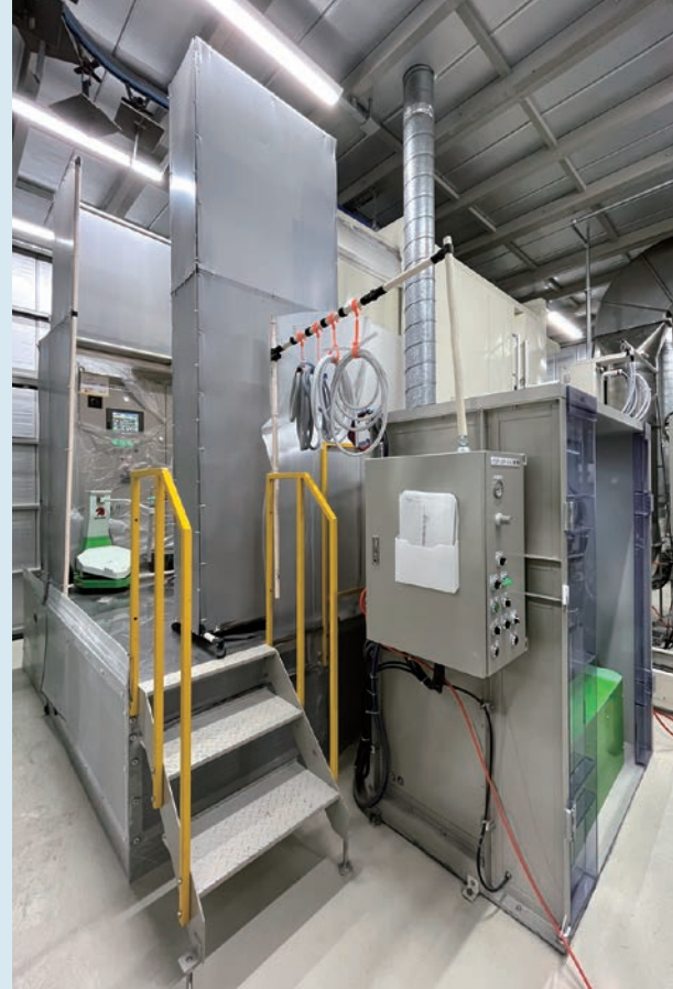
粉体塗装ブース入口側 ▲
