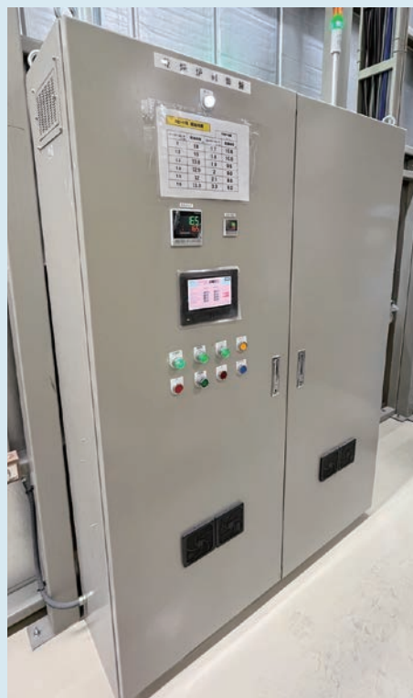
ハイブリッド乾燥システム制御盤 ▲
