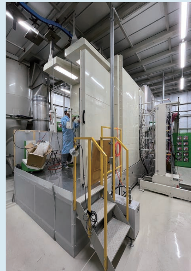
▲粉体塗装ブース出口側
